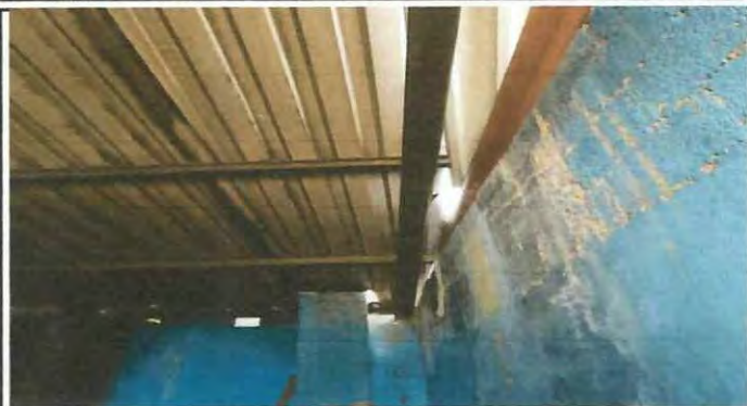
Foto1: MEJORAR EL ENTECHADO
