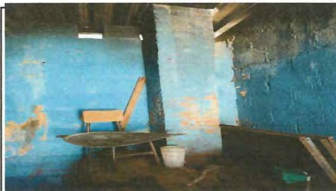
Foto 4: REPELLO Y CERNIDO EN LAS PAREDES DEL AREA DE COCINA
